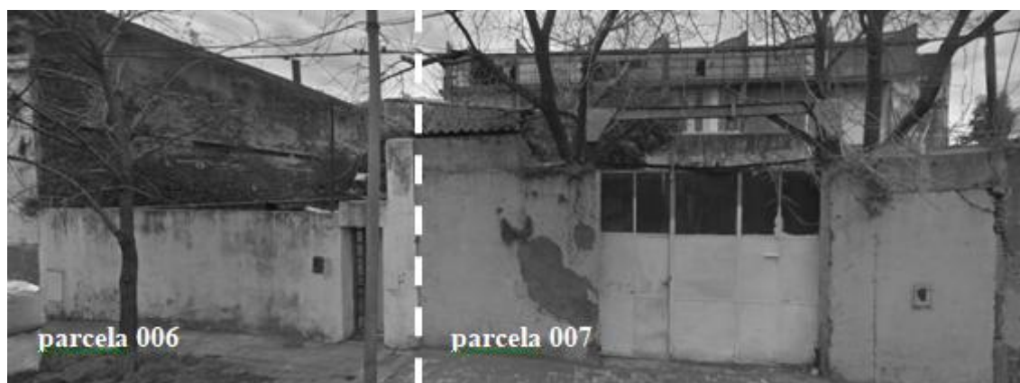
imagen 8 (Quinquela Martín entre Pedro de Mendoza y Garibaldi) parcelas 006 y 007 con edificación precaria y en mal estado
