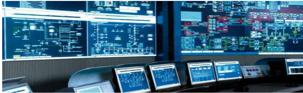
Figura 3. Centro de monitoreo SCADA
